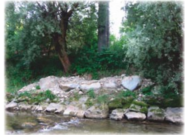
Unterspültes Fundament nach der Massnahme
